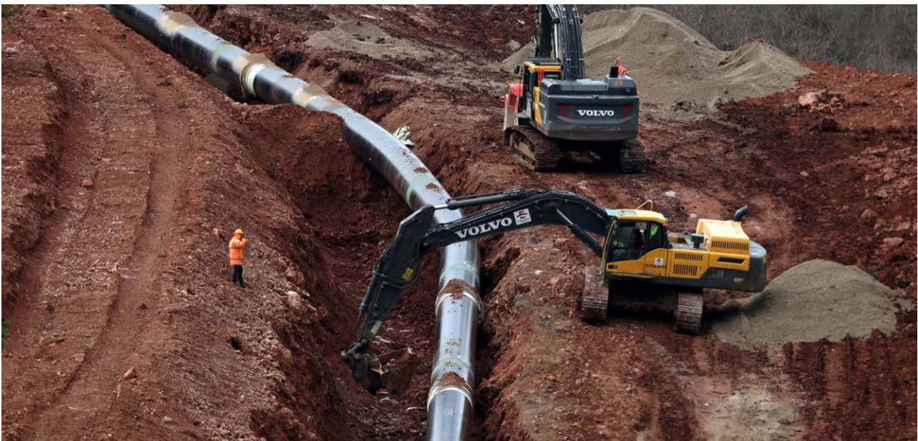
Bau der Trans Adriatic Pipeline (TAP) bei Gjanc nahe Korçe in Albanien, über die auch Gas aus Aserbaidschan nach Europa geleitet wird.
